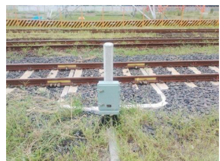
《輪重測定装置》
